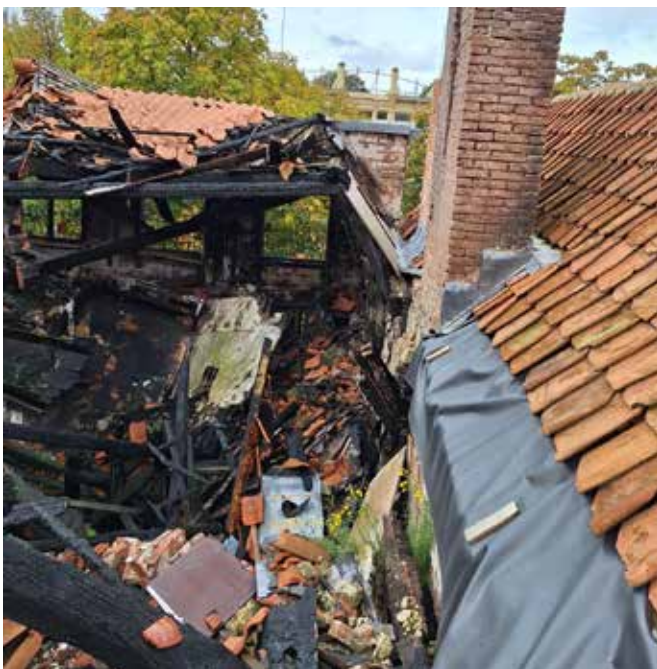
Bovenaanzicht. De grootste schade zit bij de burens. Het pand is nog steeds niet aangepakt. De kaaswinkel heeft last van vocht door de tussenmuur.
